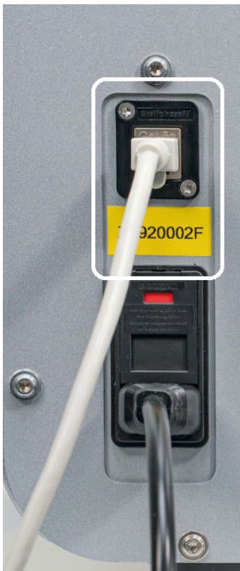
Figura 6. Ubicazione della porta RJ-45 (evidenziata dalla cornice bianca).
